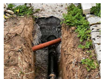
Gebäudeanschluss an ein Wärmenetz Foto: LEA
