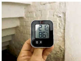
Die Luftfeuchte im Keller kann ganz einfach mithilfe eines Hygrometers im Blick behalten werden Foto: LEA
