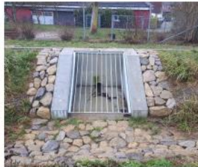
Verwallung und Einlaufbauwerk
